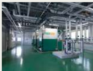
チップボイラー棟内部
