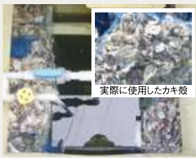
雨水利用設備
