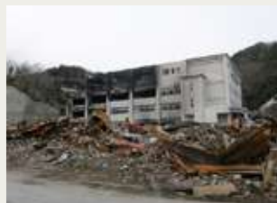
火災を受けた小学校
